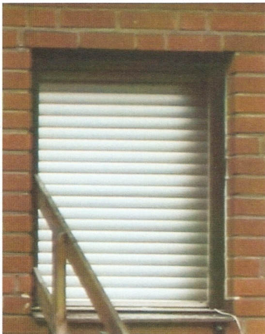
Bild 7. Fönstret där glasrutan krossats.
